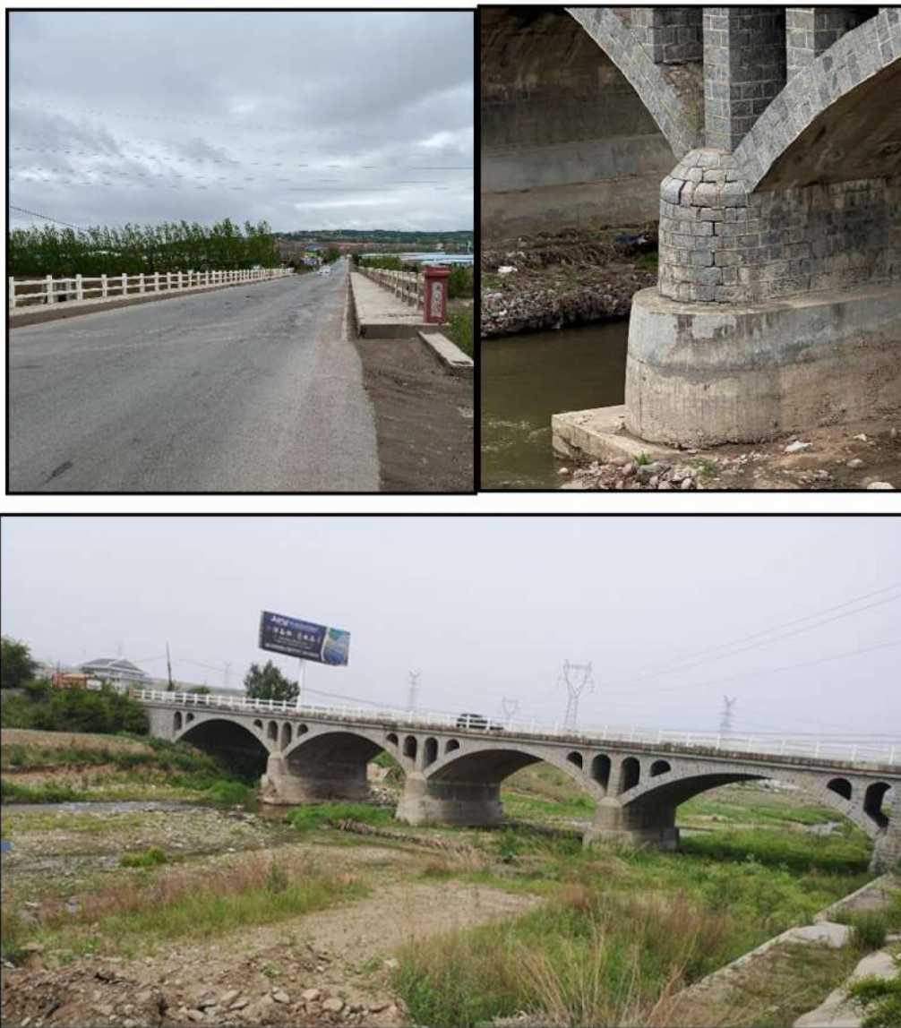
图 3 现有 k0+887 龙渊桥现状
